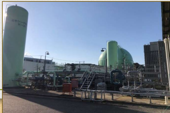
ガス生産設備
